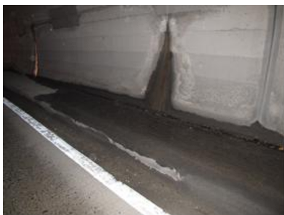
漏水による路面滞水
