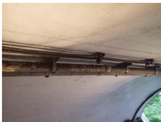
ケーブル保護管腐食
