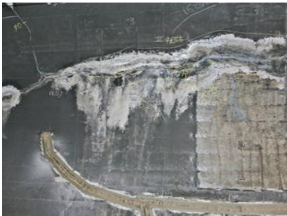
ひび割れ沿いのうき
