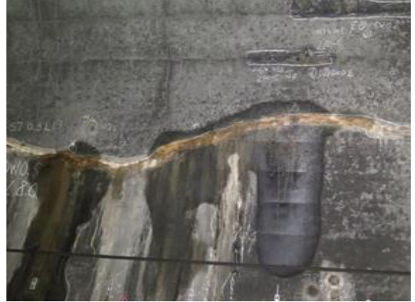
漏水を伴ったひび割れ
