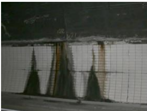
水平打継目部からの漏水
