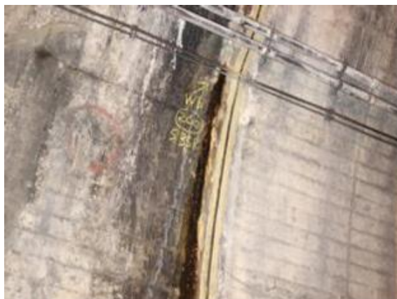
横断目地部付近からの漏水
