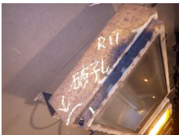
照明器具の腐食
