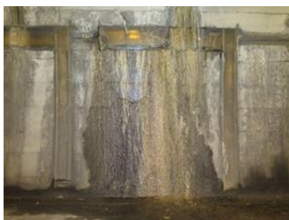
水平打継目部からの漏水
