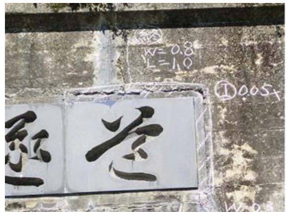
トンネル名板周辺部のうき
