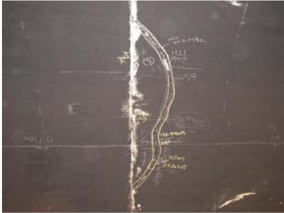
横断目地部に閉合するひび割れ
