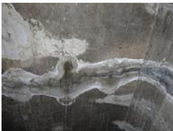
②頂版部のひび割れと漏水
