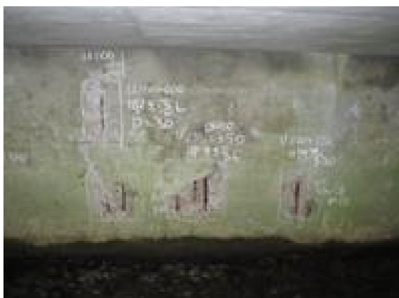
①側壁部のうき、はく離(鉄筋露出)
