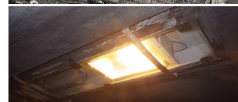
照明設備 (設置から22年経過)
