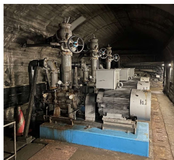
排水ポンプ (設置から14～30年経過)
