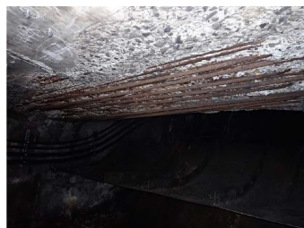
鉄筋露出状況
