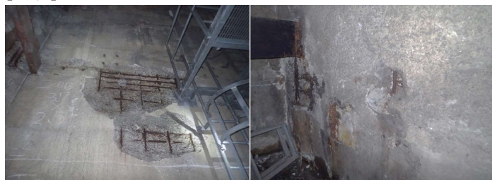
鉄筋露出状況
