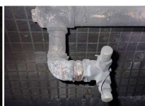
水噴霧設備 (設置から25年経過)
