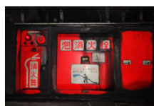
消火栓 (設置から26年経過)
