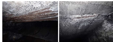
床版下面の鉄筋露出 床版下面のはく離（浮き）
