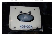
火災検知器 (設置から11年経過)
