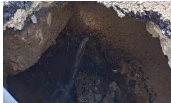
漏水・破損箇所
