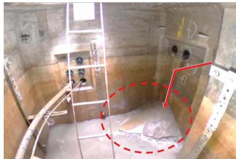
MH内土砂流入
