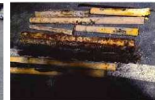
陥没箇所を掘削した結果、 確認された残置物（管路）
