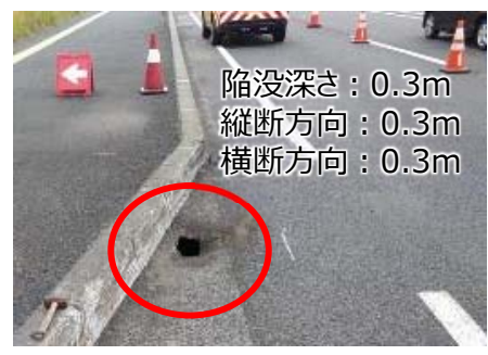
残置された管が起因した陥没事例 国道5号（北海道札幌市）
