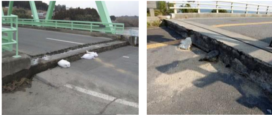
図 4-2 橋梁段差のイメージ
