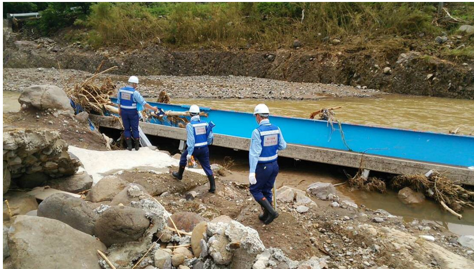
【被災状況調査班】夜明橋の橋桁の流失状況調査
