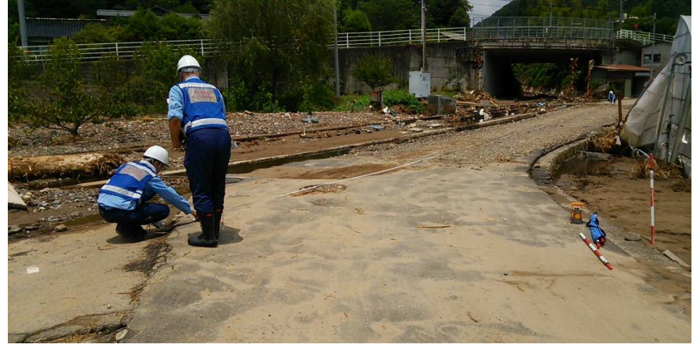
【被災状況調査班】市道竹本釜戸線の被災状況調査
