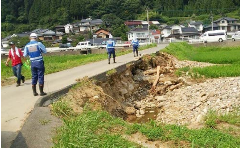
【道路②】日田市 市道調査状況 (竹本釜戸線 被災調査)
