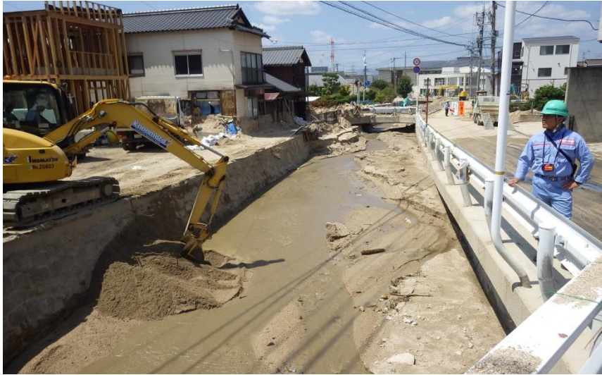
現地状況確認（坂町坂西）
