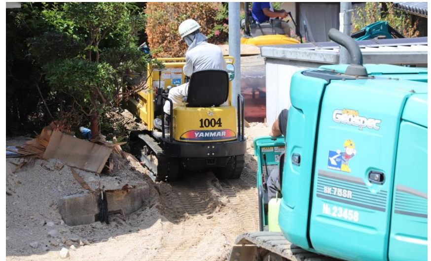
現地状況確認（坂町小屋浦）
