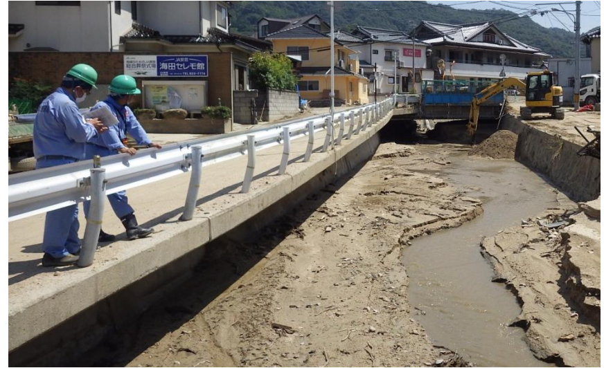
現地状況確認（坂町坂西）
