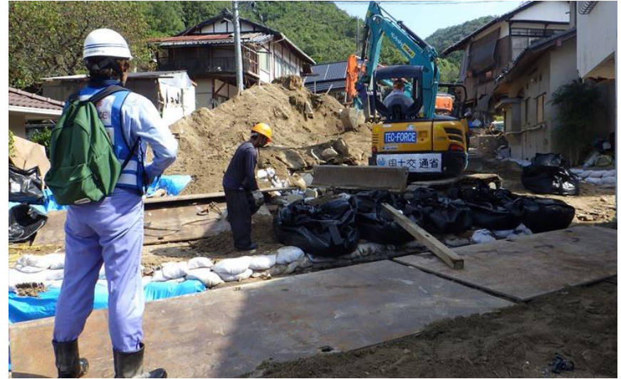
現地状況確認（呉市天応町）
