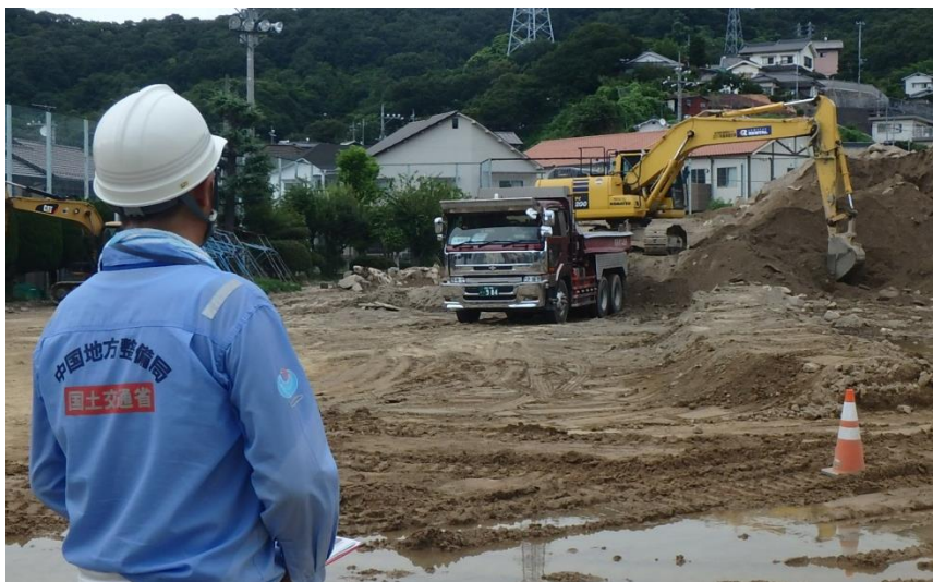
現地状況確認（坂町坂西）
