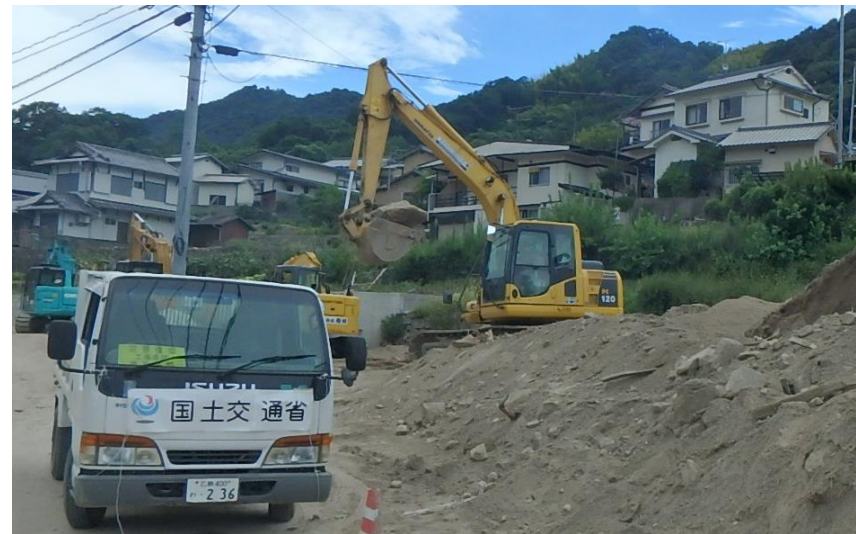
現地状況確認（坂町坂西）
