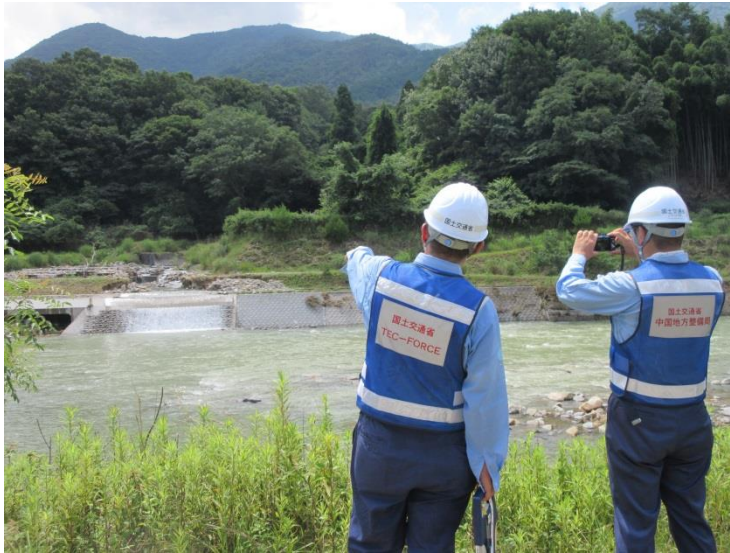
広島市(三篠川) 被災箇所確認
