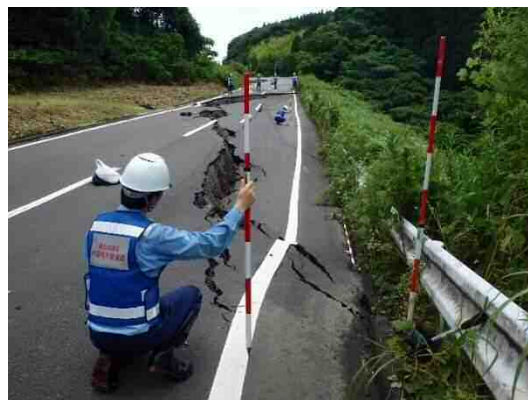
河川班・道路班 被災状況調査② （市道永吉瀬田尾線）
