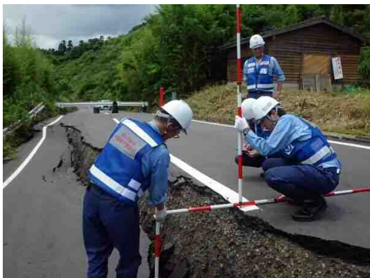
河川班・道路班 被災状況調査① （市道永吉瀬田尾線）
