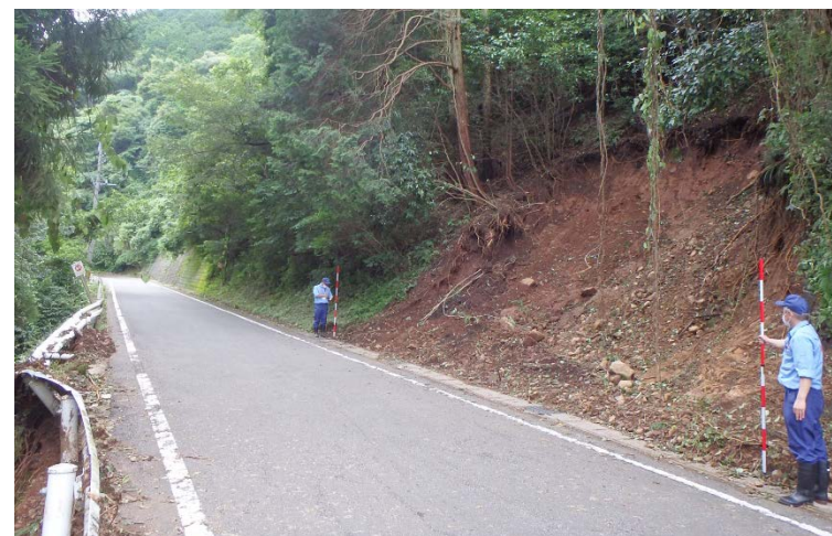
法面崩壊箇所の現地調査（熊本県人吉市）
