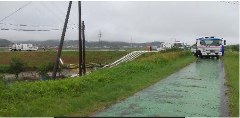
清水川排水機場
