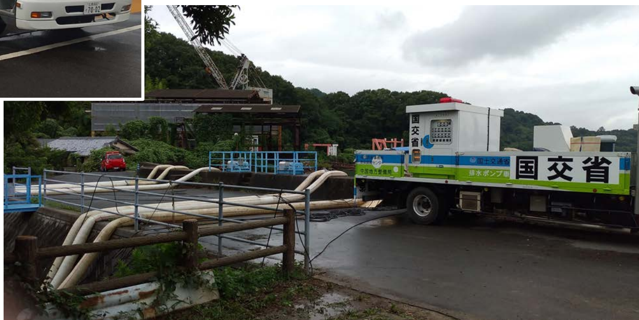
大崎上島町における排水状況
