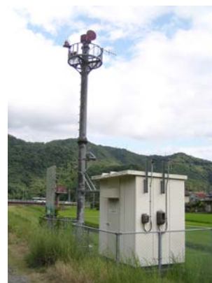
写真 5-2-17 八田原ダム放流警報設備
