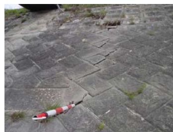
写真 2-3-2 老朽化による護岸のクラック
