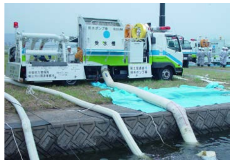
写真 5-2-30 排水ポンプ車
