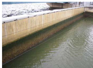
写真 2-3-6 主ゲートの劣化状況
