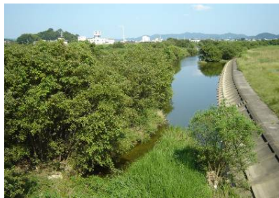
写真 2-3-3 河道内樹木の繁茂
