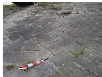
写真 2-3-2 老朽化による護岸のクラック
