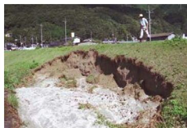
写真 2-3-8 洪水による堤防の損傷
