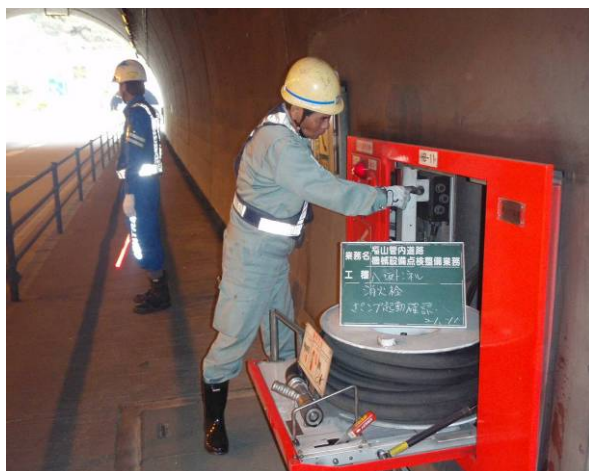
トンネル消火ポンプ点検状況
