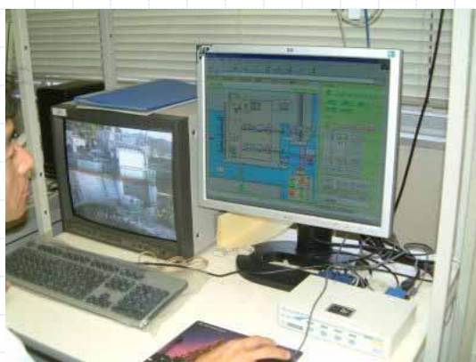
樋門の遠隔操作状況
