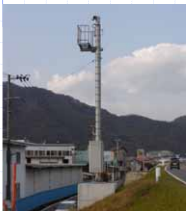
CCTVの設置状況
