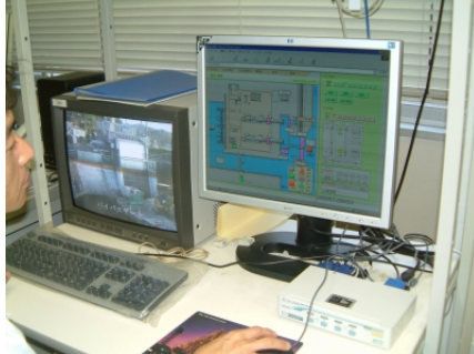
写真 5-2-29 排・取水門の遠隔操作状況
