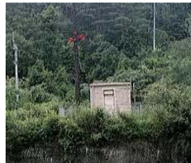
写真 5-2-17 八田原ダム放流警報設備
