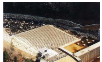
写真 5-1-11 礫間接触酸化施設
