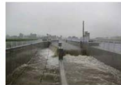
(排水分水ゲート)
