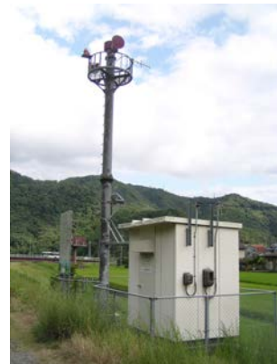
写真 5-2-17 八田原ダム放流警報設備
