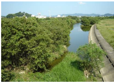
写真 2-3-3 河道内樹木の繁茂
