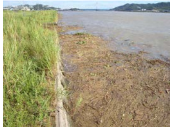
写真 5-2-14 洪水後の塵芥堆積状況
