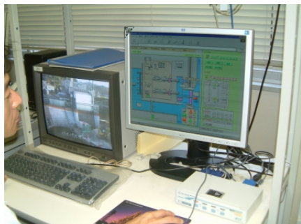
写真 5-2-29 排・取水門の遠隔操作状況
