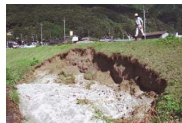
写真 2-3-108 洪水による堤防の損傷
