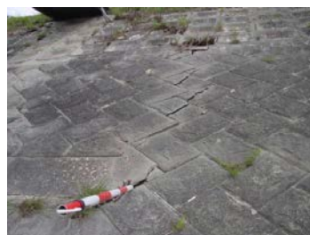
写真 2-3-2 老朽化による護岸のクラック
