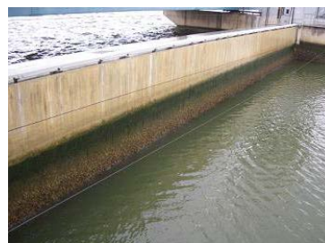
写真 2-3-6 主ゲートの劣化状況
