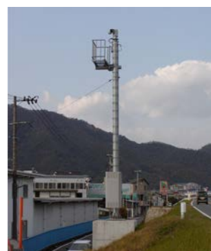
写真 5-2-11 CCTV の設置状況
