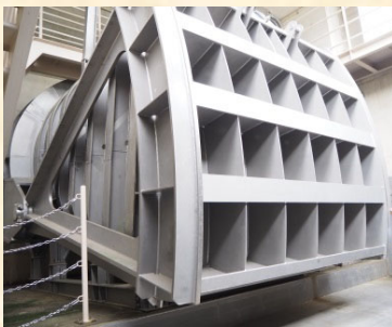
普段は見られない設備を見てみよう！ (写真：低位放流設備)
