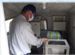
ダム観測機器の点検
