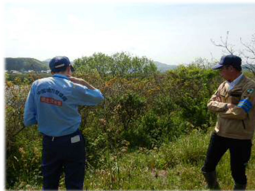
河川内に繁茂した樹木
