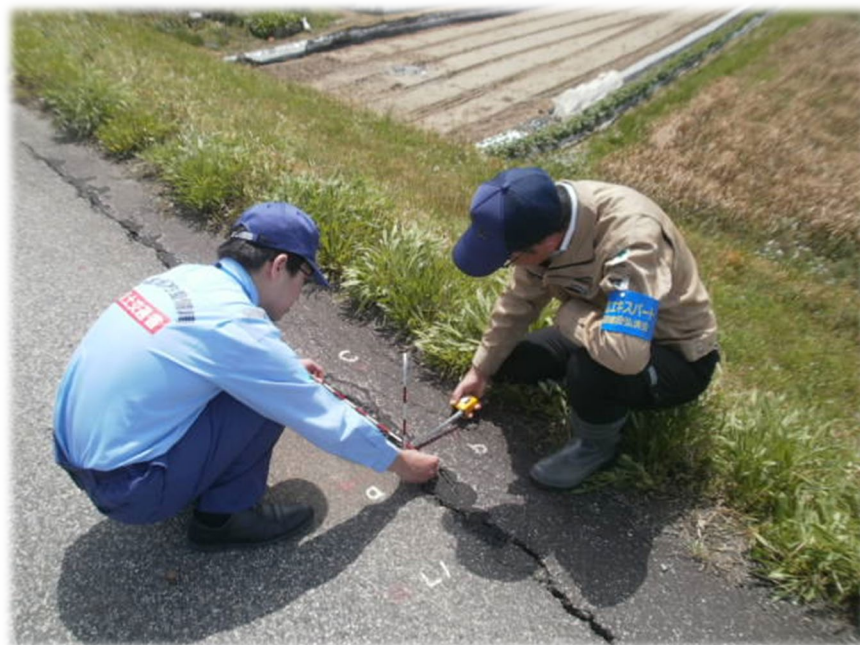
堤防頂部の亀裂
