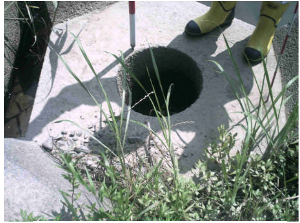
根固めブロック間詰め石の流出(益田市高津町)
