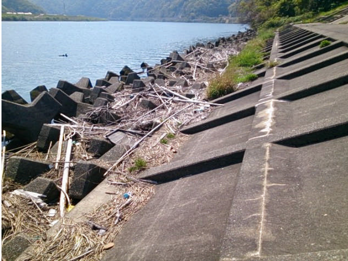
河道内の流木堆積（江津市江津町）
