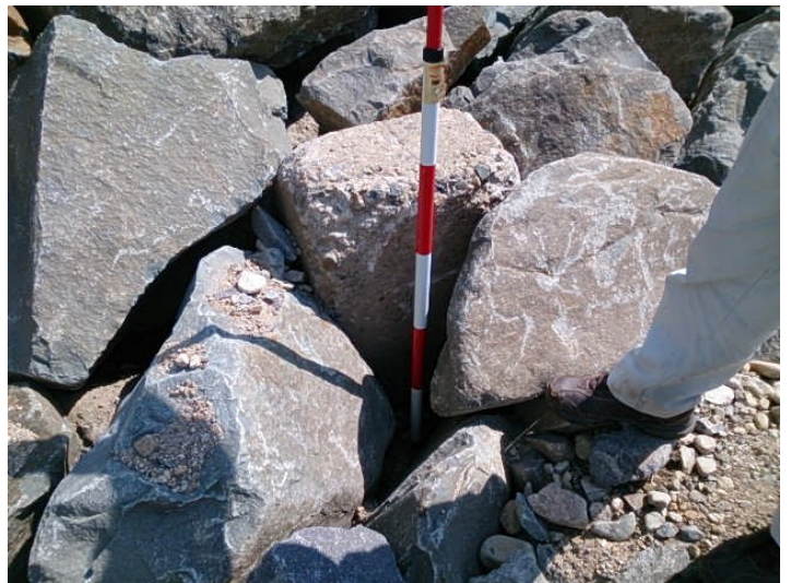
捨石護岸の隙間（川本町因原）
