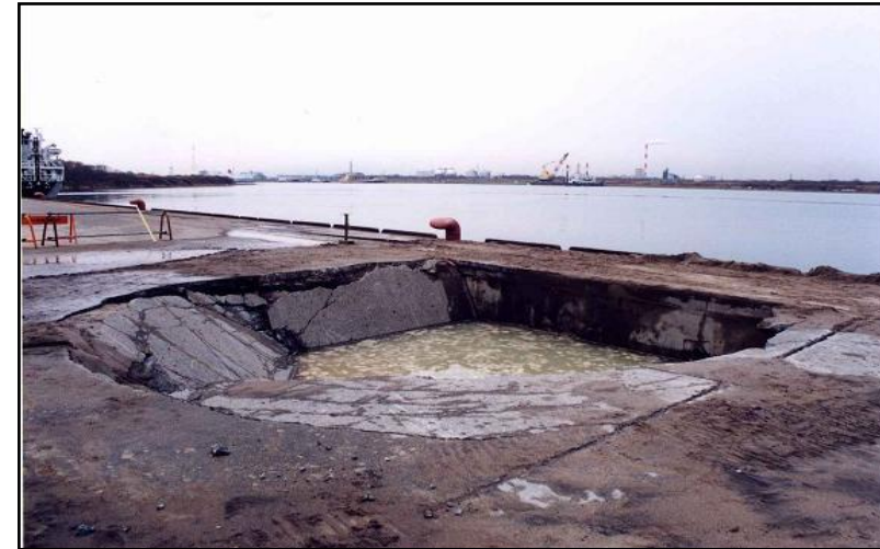
港湾施設エプロン部分の陥没
