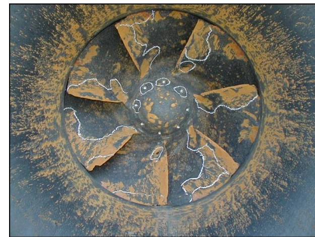
腐食した排水ポンプ場の羽根車
