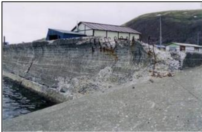
老朽化した海岸堤防
