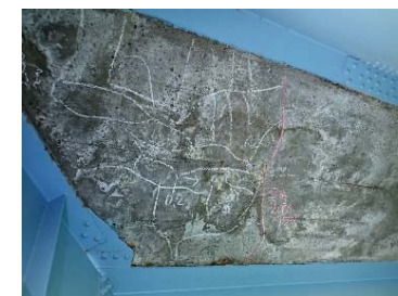
床版下面のひびわれ、変色、漏水・遊離石灰、床板の土砂化 (国道9号 新井橋) (鳥取県岩美町)
