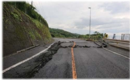
令和3年8月大雨(地すべり) (島根県出雲市)
