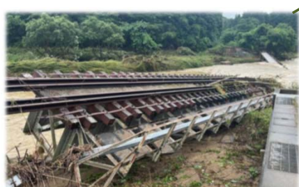
令和5年6月豪雨 (山口県美祢市)
