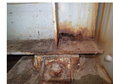
主桁 (桁端部) の腐食・減肉・欠損 (国道2号 五日市高架橋) (広島県広島市)
