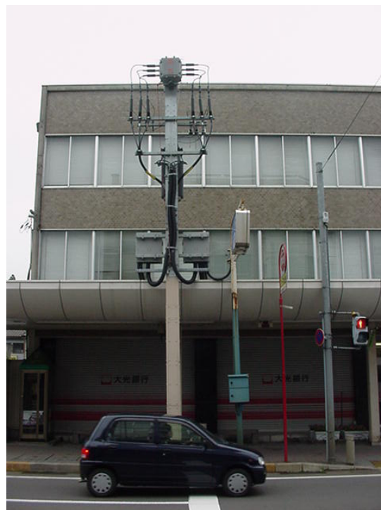
写真 1-5 アーケードポール方式実施箇所例
