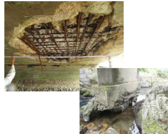
道路施設の老朽化
