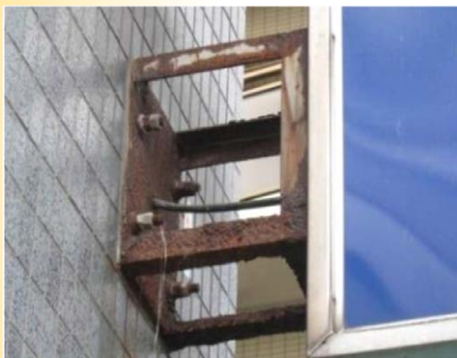
ブラケットの腐食による落下の危険のある看板 (国土交通省HPより)
