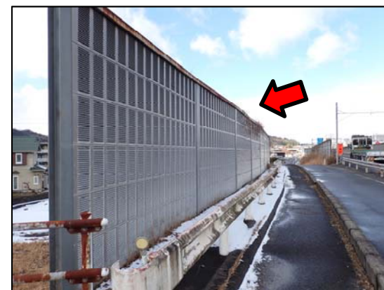
ランプ部遮音壁 （高さ 3 m）
