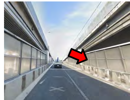
高架部遮音壁(ランプ部) (高さ約2m)
