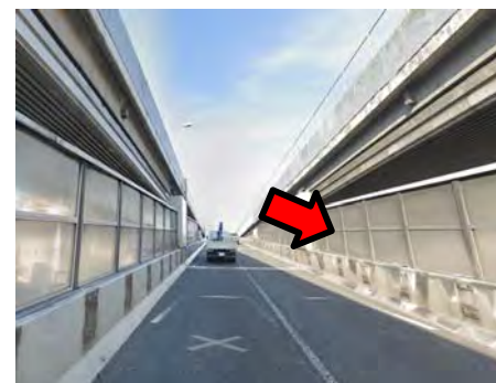
高架部遮音壁(ランプ部) (高さ約2m)
