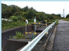
監視カメラ設置状況
