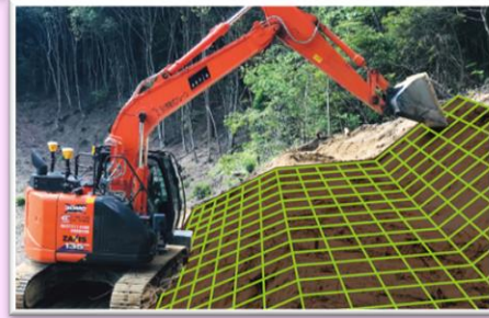
半自動制御されたICT建機を使って3次元設計データ通りに施工が可能となり、施工精度が向上します。
