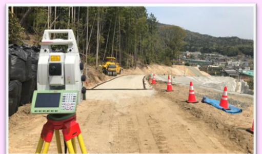
施工中や完成時に現地が設計通りになっているかリアルタイムでチェックできます。
