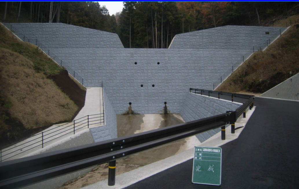
廿日市市宮園四季が丘 (コンクリート堰堤)
