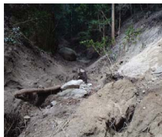
源頭部の崩壊状況
