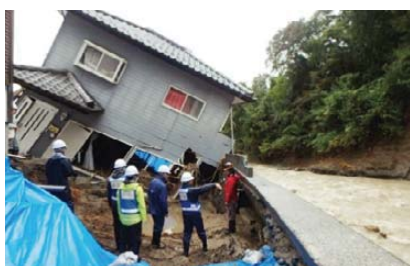
被災状況の確認 (埼玉県秩父市)
