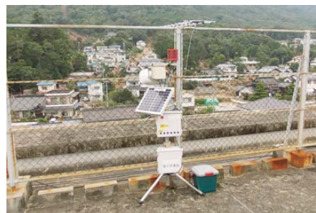
土石流警報装置（サイレン）設置状況
