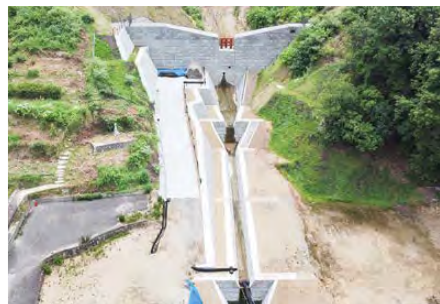
呉市天応町 瀬戸の川支川 (令和3(2021)年6月)
