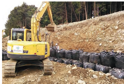
崩れた土砂の再移動防止や流路確保を目的とした大型土のうの設置
