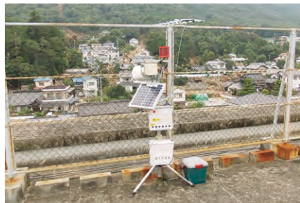
土石流警報装置(サイレン)設置状況
