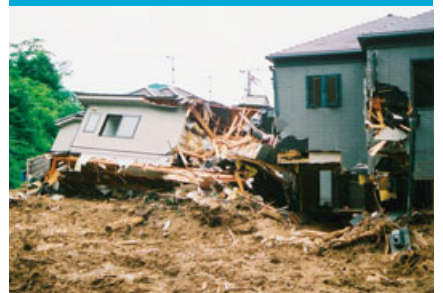
土石流による被災状況(広島市安佐南区伴東)
