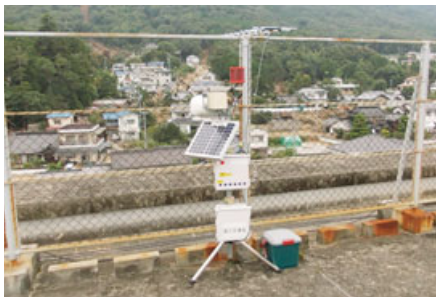
土石流警報装置(サイレン) 設置状況
