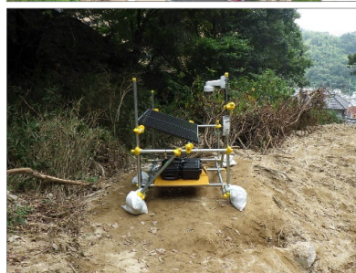
監視カメラ設置状況
