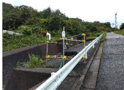
監視カメラ設置状況
