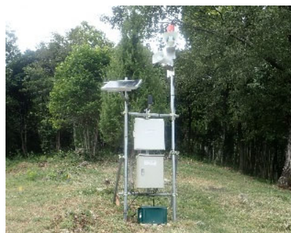
土石流警報装置設置状況
