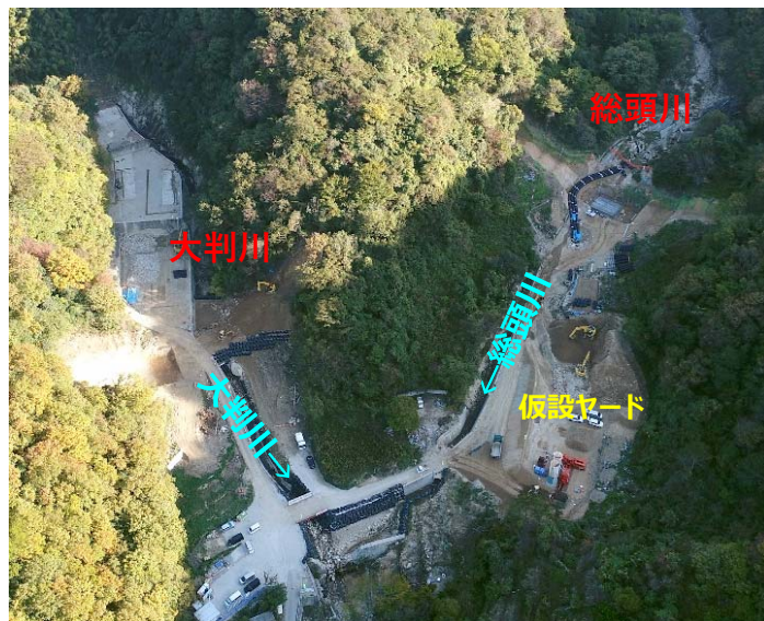
総頭川・大判川状況（下流より）
