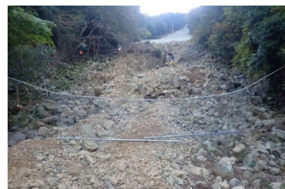
写真-13 下部 簡易落石防護柵
