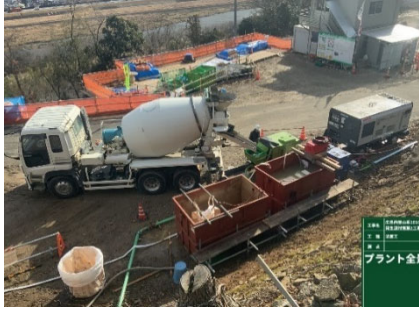
写真-5 プラント全景
