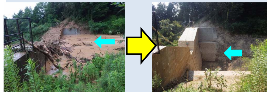
土石流発生直後（R2.7.7撮影）
