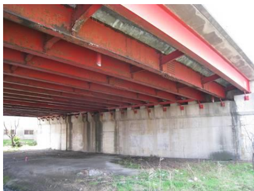
対策前（塗装劣化）
