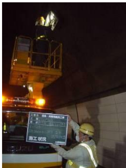
トンネル照明球替
