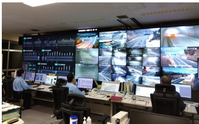
高規格道路管制センター
