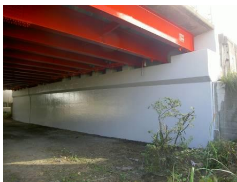
対策後（塗装劣化）
