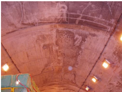
コンクリート剥落防止対策前
