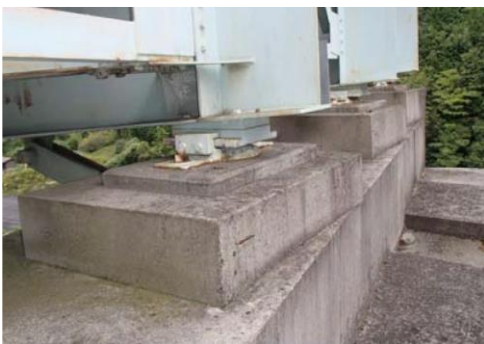
対策前（支承部補強）
