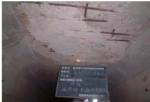
函渠下面の剥離・鉄筋露出
