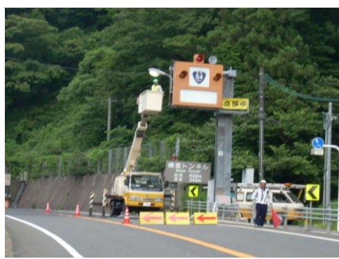
警報設備点検
