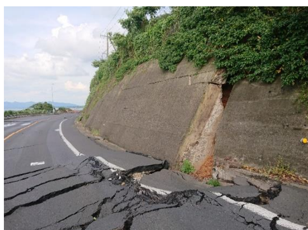
国道9号 島根県出雲市多伎町 地すべり
