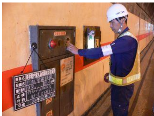
電気設備点検（トンネル警報設備）
