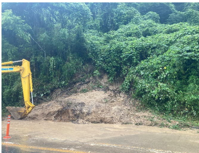
国道2号 山口県岩国市周東町 法面崩落
