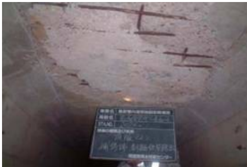
函渠下面の剥離・鉄筋露出
