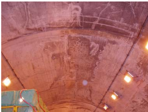
コンクリート剥落防止対策前
