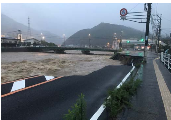
国道2号 広島県広島市安芸区中野 護岸流出
