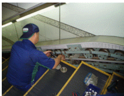
昇降機設備点検（エスカレーター）
