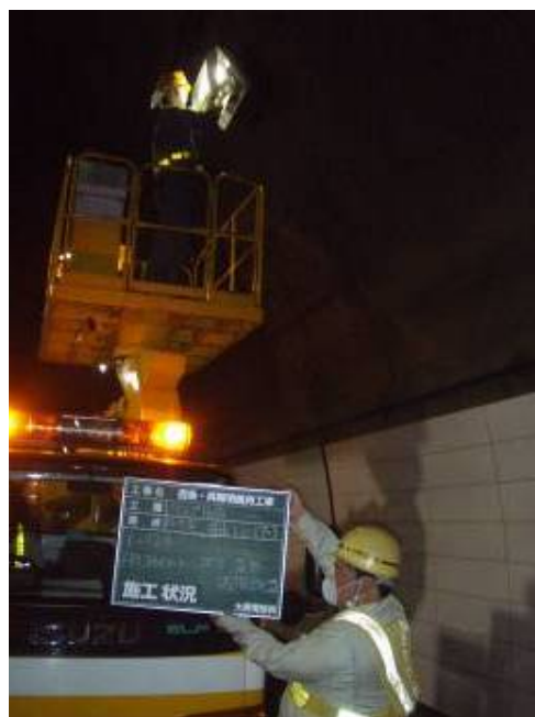
トンネル照明球替
