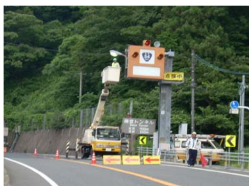
警報設備点検
