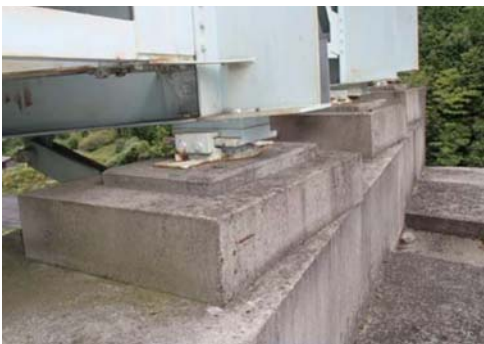
対策前（支承部補強）
