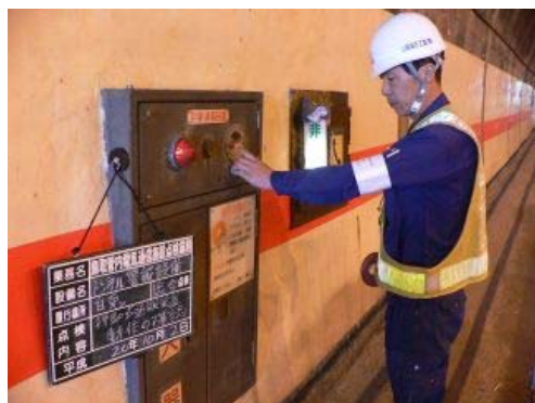
電気設備点検（トンネル警報設備）
