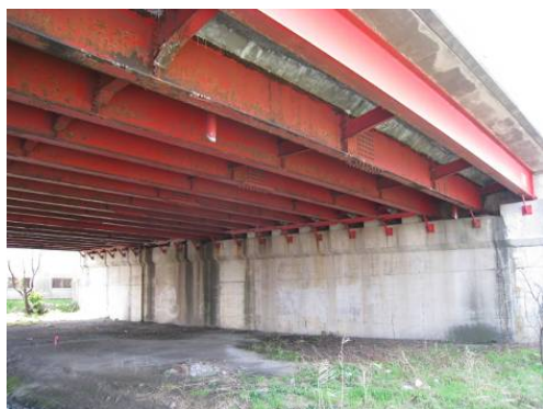
対策前（塗装劣化）
